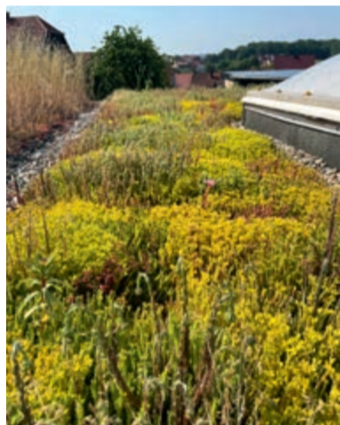
Fertig kultivierte Sedummatte nach mehrmonatiger Anwuchsphase, mit Extensivsubstrat, Substratmatte SM50 und Drainagesystem X20.
