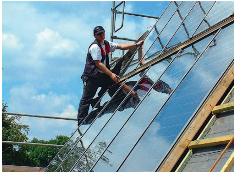
Photovoltaik auf den Dächern.
