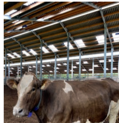
Doppelnutzung geplant: Landwirte planen die Montage weiterer PV-Anlagen auf ihren Stalldächern. Oft wird vorher die Eindeckung saniert.
